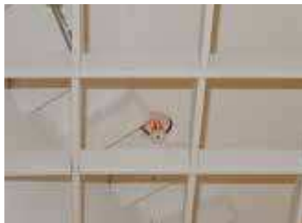
Transportsikringen som ikke er fjernet når sprinklerhodet er montert. Det har den fargen av en grunn. I tillegg vil rasterhimlingen hindre en riktig spredning fra sprinklerhodet.
