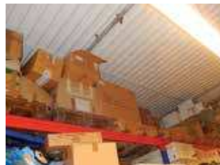
Sprinkleranlegget skal være prosjektert for å beskytte den bruken som skal være i bygget. De som prosjekterer sprinkleranlegg vet at det i kjøpesenter blir lagring. I tillegg må det være en avstand mellom sprinklerhode og topplagret vare for at spredningen fra sprinklerhodet skal dekke det forventede areal.
